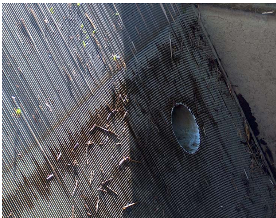
Figur 1. Ungfiskeslusen består af en cirkulær åbninger i turbinegitteret, placeret ca. 0,5 m under vandoverfladen. Herfra ledes fiskene i rør og via to bassiner til det gamle åløb nedstrøms værket.
